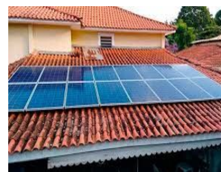
Geração de Energia com Fotovoltaica
